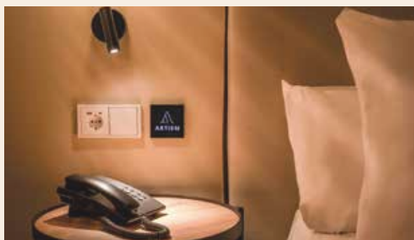
Sistema de domotización a pared en ARTIEM Capri
